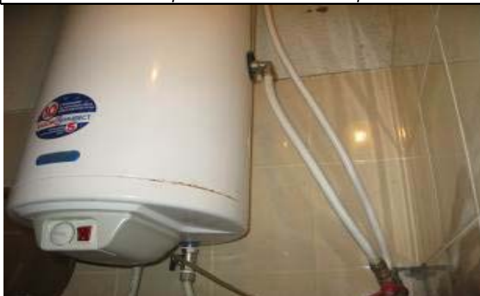
Електрически обмен бойлер
